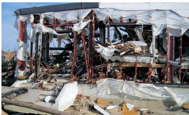
2011年3月11日の東日本大震災による被害状況 宮城県荒浜港
